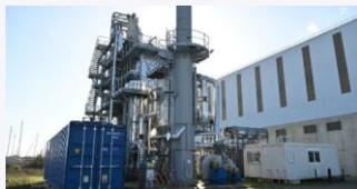
Une unité de pyrogazéification de biomasse installée sur la plateforme R&D de Leroux & Iotz à Nantes (2022)
